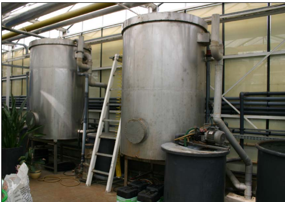
Foto 1: Ontijzeringsinstallatie op glasgroentebedrijf met trostomaten op substraat
